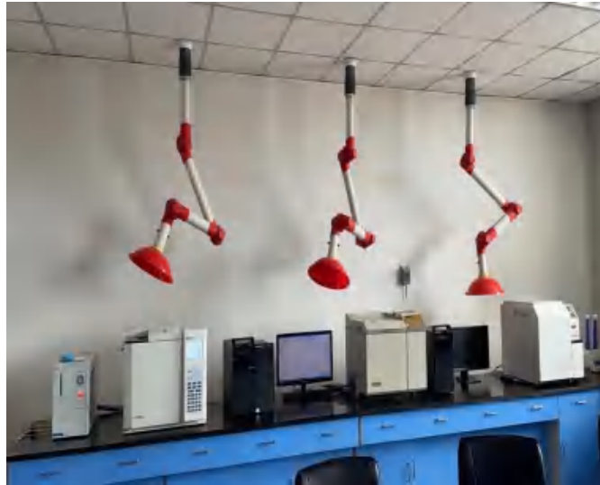
图 3.3.2-4 实验室废气集气罩装置
