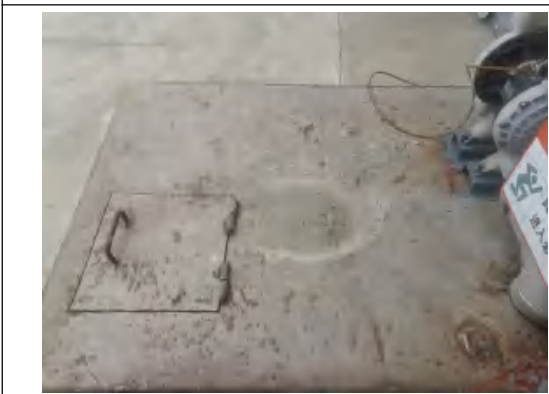
堵漏设施（收集池）
