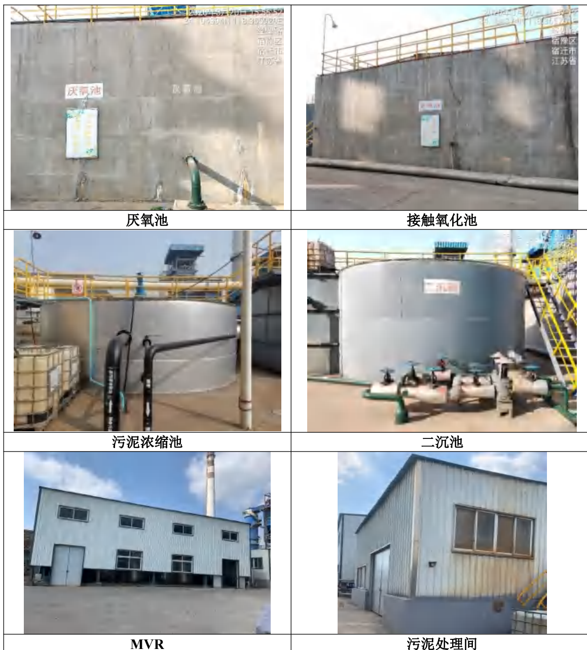
图3.3.1-2 废水治理设施图片
