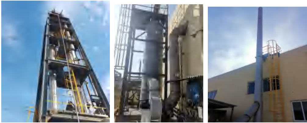
一氧化碳废气排气筒
